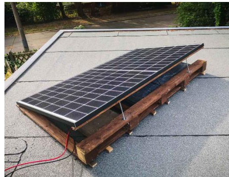
Geeignete Bautenschutzmatte fehlt hier
